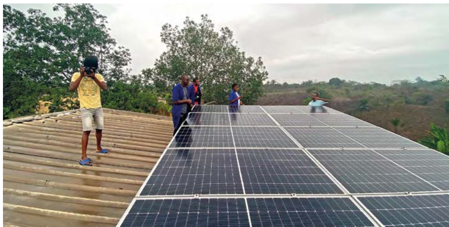
© Africafrance Solidaire / Projet panneaux photovoltaïques
